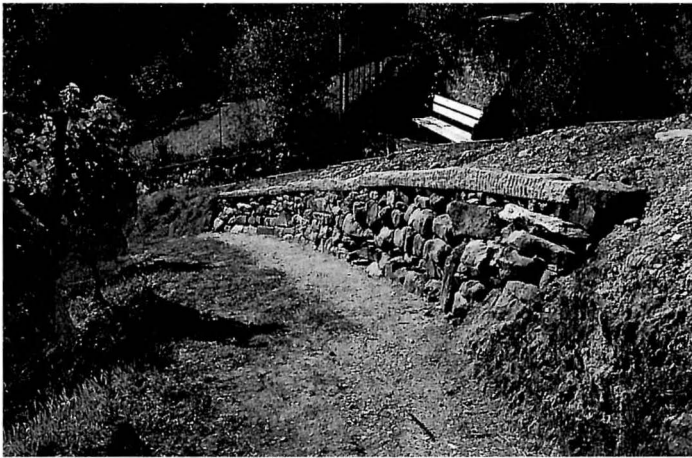
Die Bruchsteinmauer dient nicht nur als neues Stützelement im Steilhang, sondern auch als Lebensraum für die gefährdete wärmeliebende Flora und Fauna.
