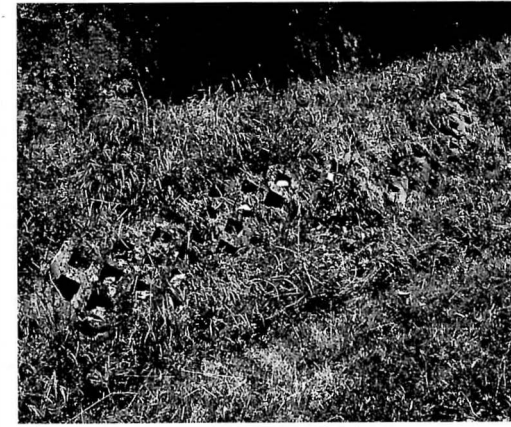
Eine baufällige und biologisch wertlose Hangsicherung aus Gittersteinen musste einer fachgerecht aufgebauten Trockenmauer weichen.
