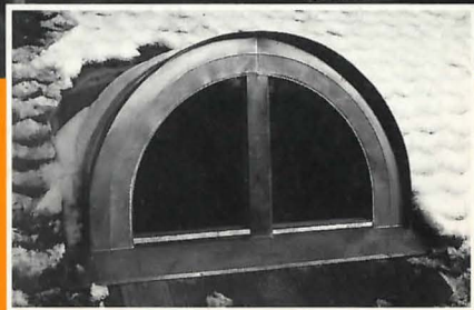
Das Zieglerhaus mit neuem Ausblick: Das als «Gaube» gestaltete Dachfenster bringt Sonnenlicht in den erweitert ausgebauten Dachstock.
