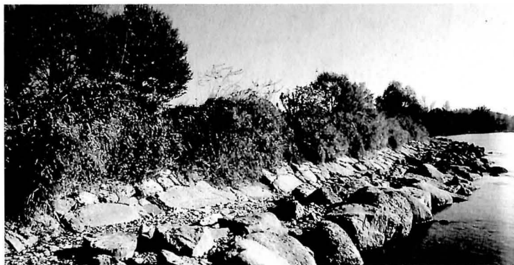
Abb. 1: Hart verbaute Uferlinie an der zürcherischen Reuss südlich der Obfelden-Merenschwand-Brücke. Im Konzept zur Revitalisierung als erste Sanierungsetappe vorgesehen, wurde diese Uferstrecke dann aber herausgestrichen. Wir hoffen, dass in absehbarer Zukunft solche Uferlinien zugunsten von mehr Raum und Dynamik für den Fluss aufgewertet werden können. (Foto J. Fischer).
