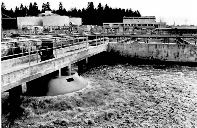
Abb. 7 Blick auf ein Belebungsbecken der ARA Buholz in Emmen bei Luzern. Die Erstellung dieser Anlage war Vorbedingung für den Aufstau der Reuss durch das Kraftwerk Bremgarten-Zufikon. Links eine der 12 Turbinen der Oberflächenbelüftung. (Fotos: E. Kessler)
